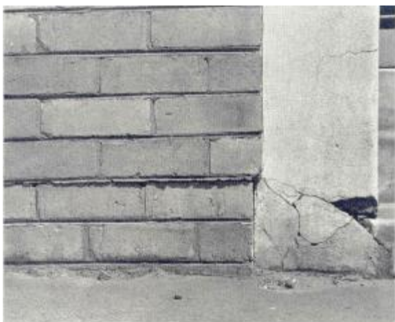
Sl. 5: Usled pojave napona u zidu dugom 20 m došlo je do pucanja betonskog stuba
