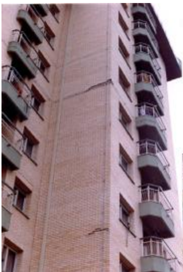
Sl. 4: Prikaz oštećenja fasadnog zida od opeka usled vlažnog širenja
