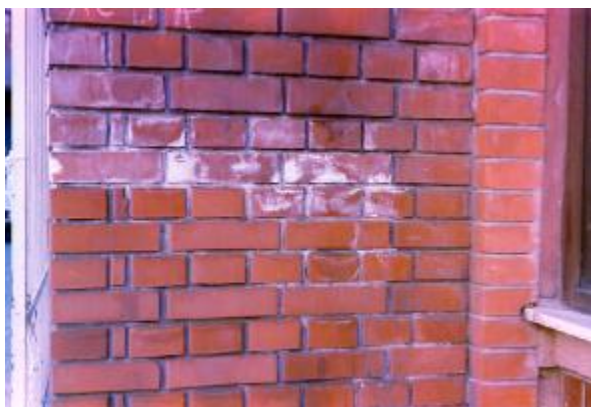
Sl. 9: Prikaz iscvetavanja rastvornih soli na površini fasadnog zida od opeka
