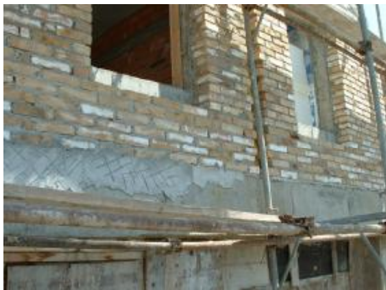
Sl. 13: Pojava iscvetavanja rastvornih soli u toku gradnje objekta
