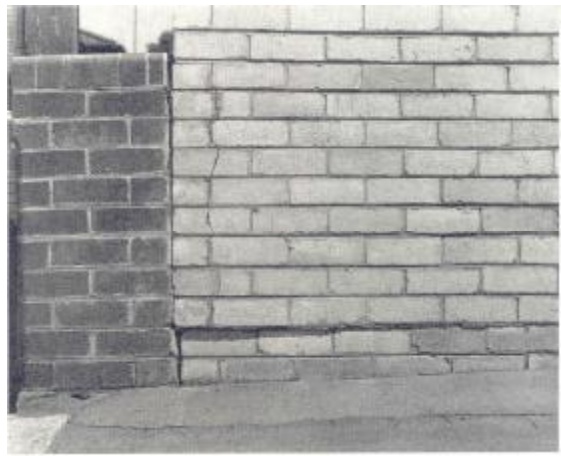
Sl. 6: Na mestu sučeljavanja dva zida usled pojave napona u zidu javlja se pukotina
